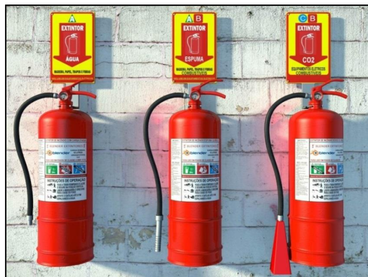
Figura 37: Imagem ilustrativa dos tipos de extintores.
