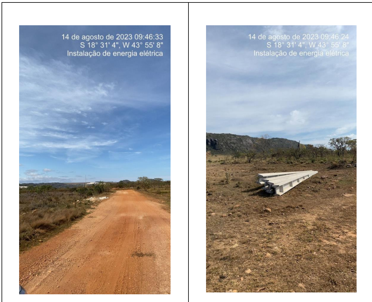
Figura 45: Instalações de energia elétrica na região da AID.
